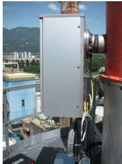
Installazione dell'unità di campionamento
